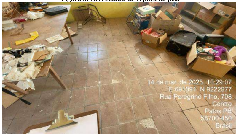
Figura 5: Necessidade de reparo do piso
