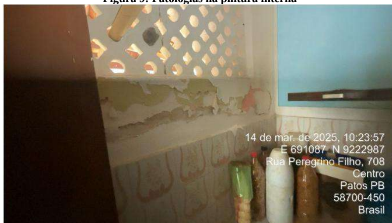
Figura 9: Patologias na pintura interna
