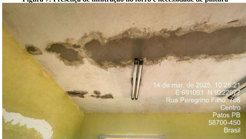
Figura 7: Presença de infiltração no forro e necessidade de pintura
