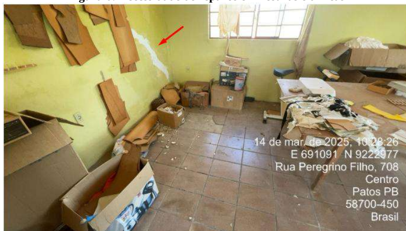
Figura 6: Necessidade de reparos em fissuras e trincas
