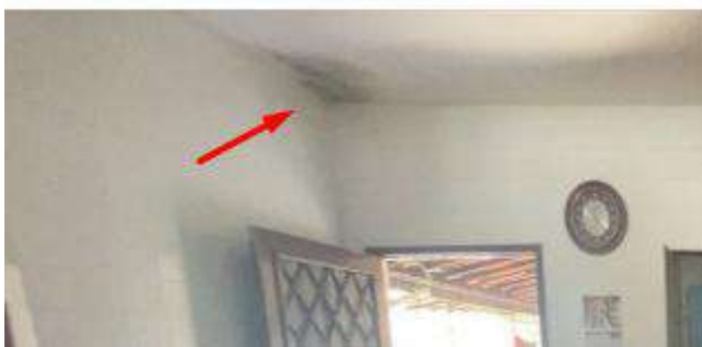
Figura 10: Presença de infiltração
