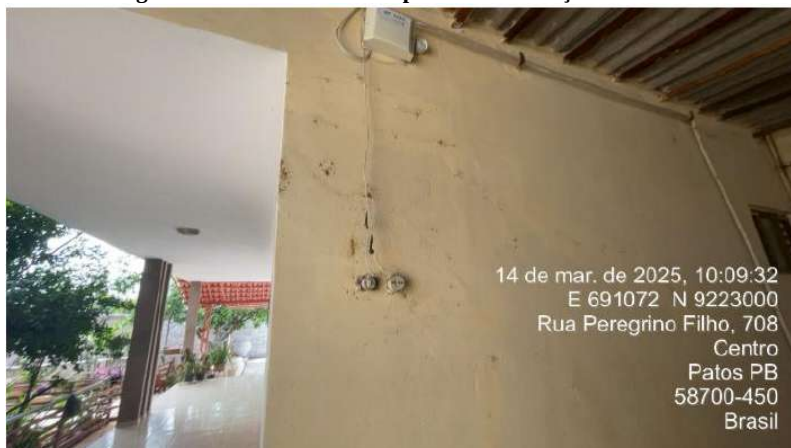
Figura 11: Necessidade de reparo das instalações elétricas
