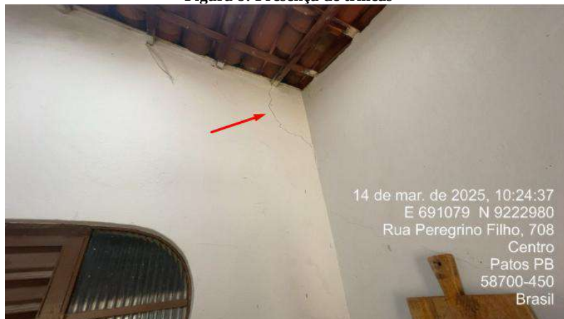
Figura 8: Presença de trincas
